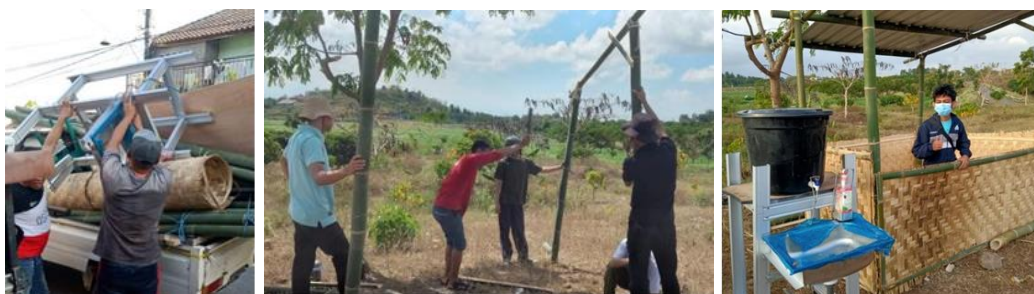
Gambar 11. Pengangkutan bahan baku untuk pembuatan sarana dan prasarana (a) Pemasangan pondasi bangunan (b) Tampak bangunan dan area cuci tangan selesai (c)
